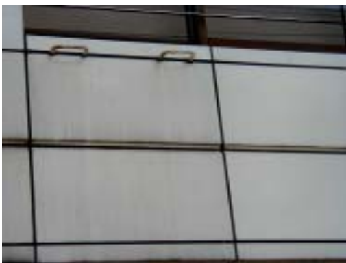
ビル外壁の防汚。 コーティングなしの左側は黒く汚れている。(カタログから)
